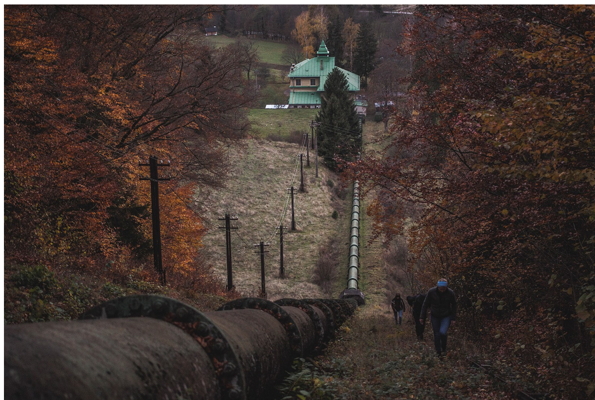
Súčasný pohľad na HC Jasenie a ocelové tlakové potrubie od horného privádzača.
