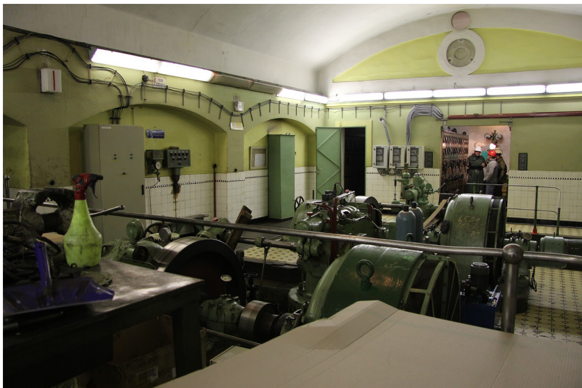
Podzemná elektrárň v hĺbke 245 m postavená v roku 1912.
