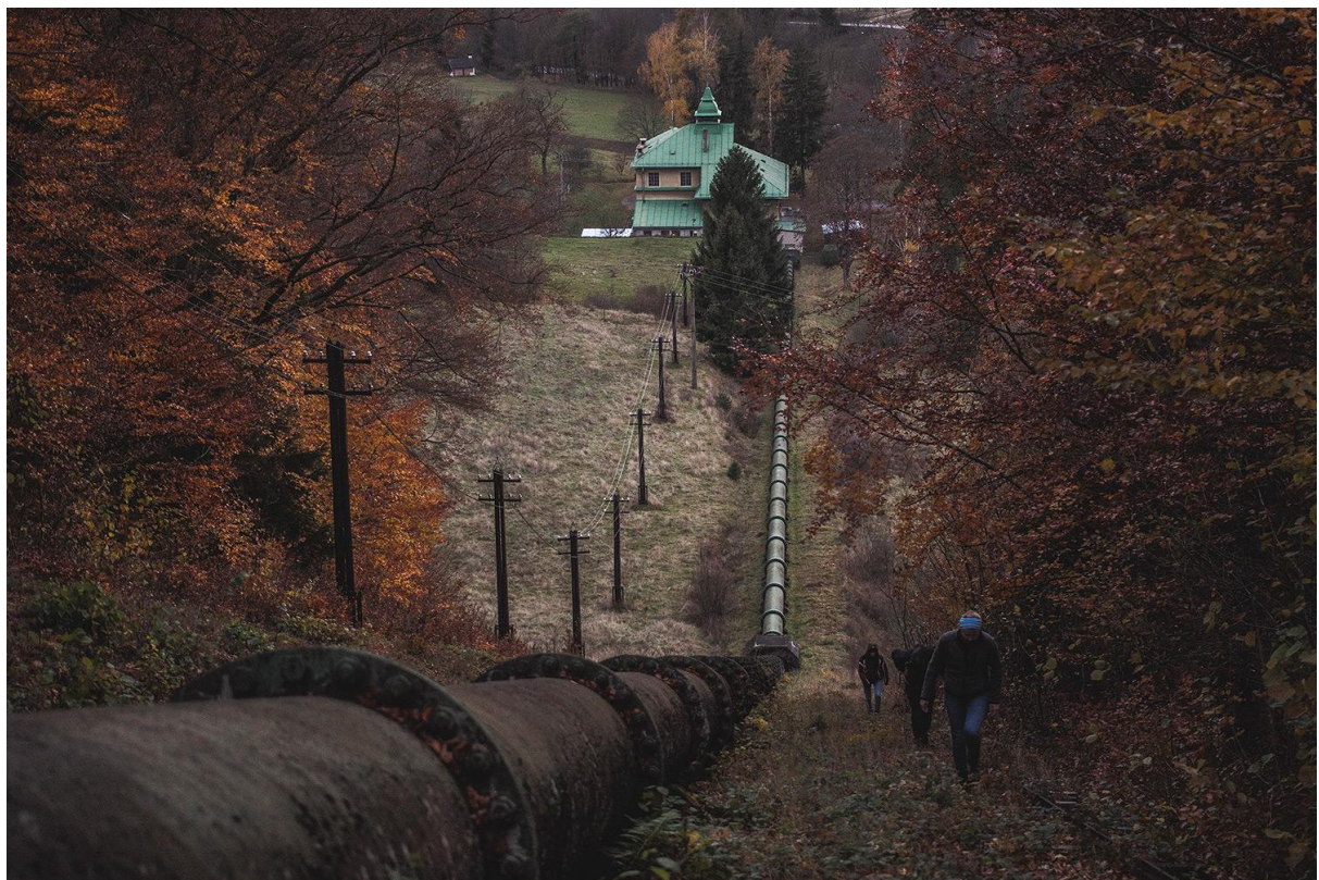
Obr. 135. Súčasný pohľad na HC Jasenie a ocelové tlakové potrubie od horného privádzača.
