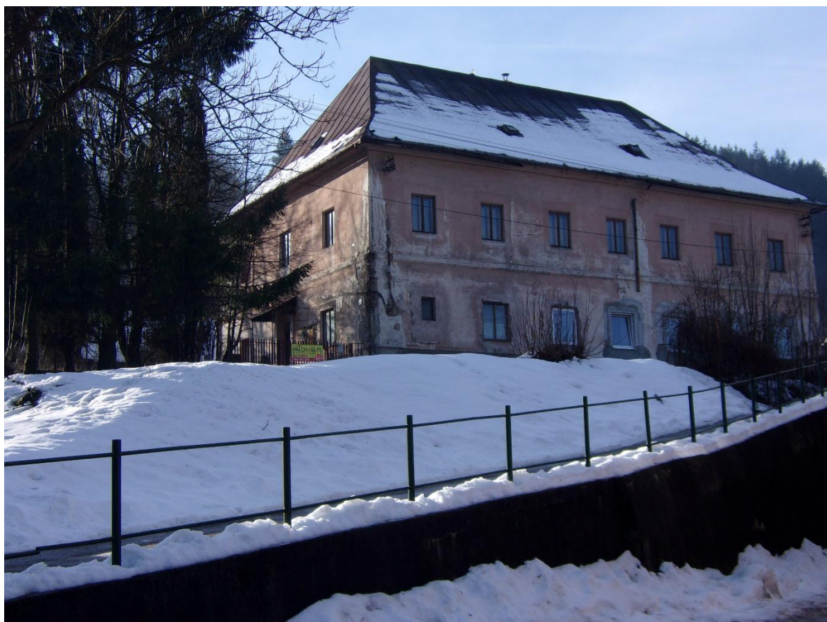
Obr. 30. Súčasný žalostný stav komorského bytového domu pri kostole zo začiatku 19. storočia. Pohľad od cesty po nevhodnej výmene okien. Klenby sú na oboch podlažiach.
